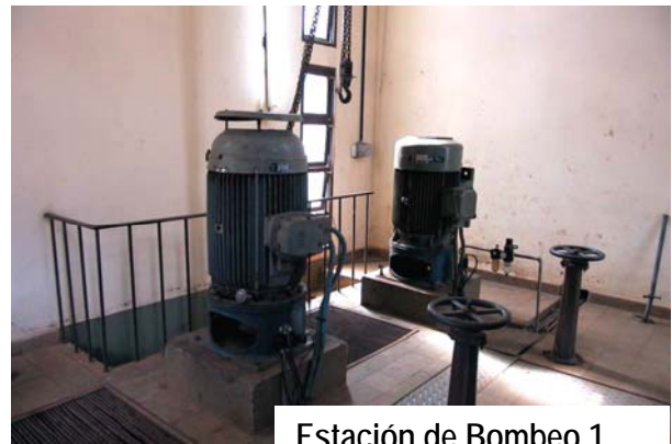
Estación de Bombeo 1
